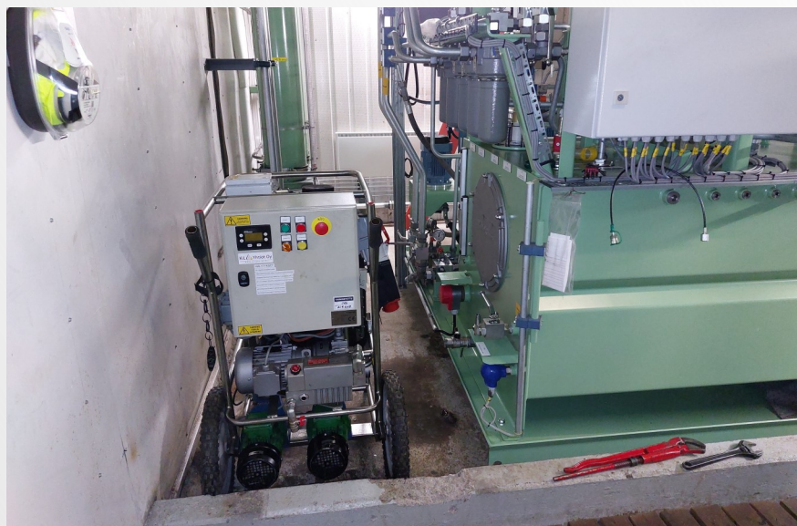
Kuva. Säätö-öljyjärjestelmän öljysäiliö ja OilChamp 1820 alipainehöyrystin.
